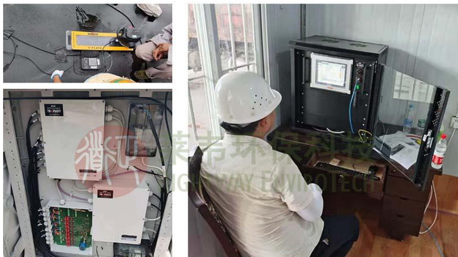
永久渗漏监控系统中控机房
